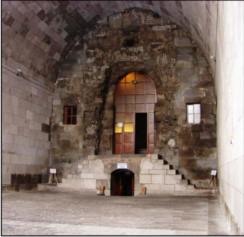
Foto. 15: Ana eyvan ve türbe kapıları (onarım öncesi)
