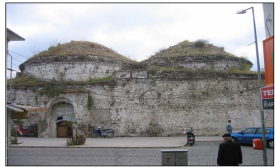
Foto. 4: Batı Cephe (Onarım Öncesi)
