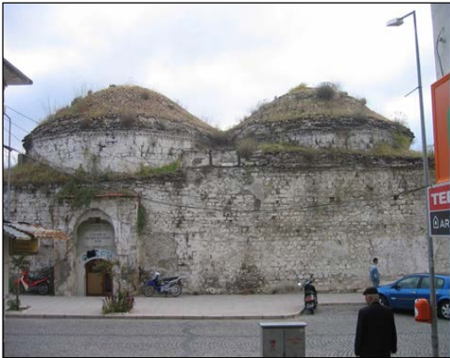
Foto. 15: Batı Cephe (Onarım Öncesi)
