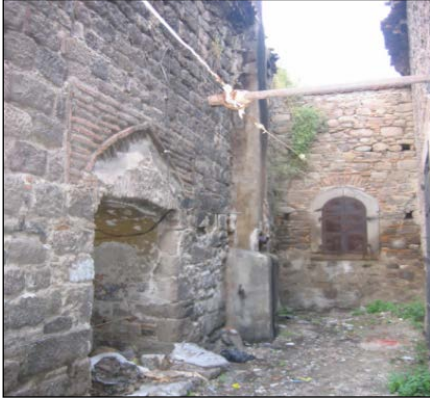
Foto. 7: Kuzey Cephede Kapatılan Pencere
