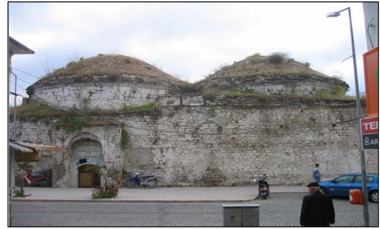
Foto. 4: Batı Cephe (Onarım Öncesi)
