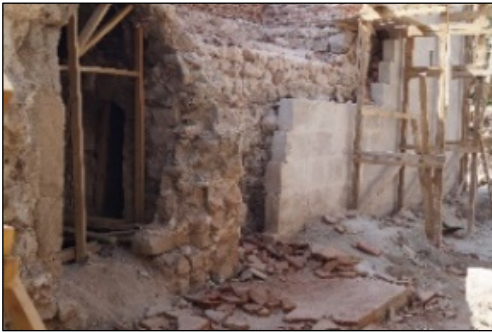
Foto. 3: Darphane, taç kapı, onarım esnasındaki görünüşü (topuklar ortadan kaldırmış, zemine beton dökülmüş), detay, (B. Deniz, 2002)
