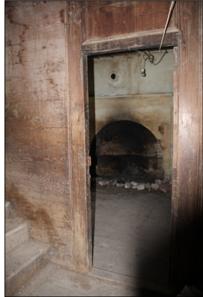
Foto. 8: Zemin Kattaki Ocak
