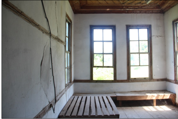
Foto. 11: İkinci Kattaki Cumbanın Pencerelemi
